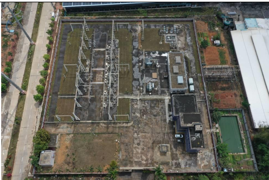
110千伏大槐站生态恢复情况
