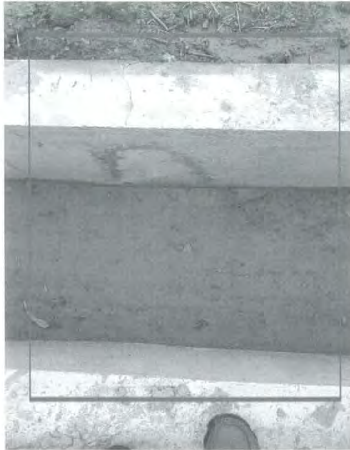
图 24 渠道裂缝及淤积
