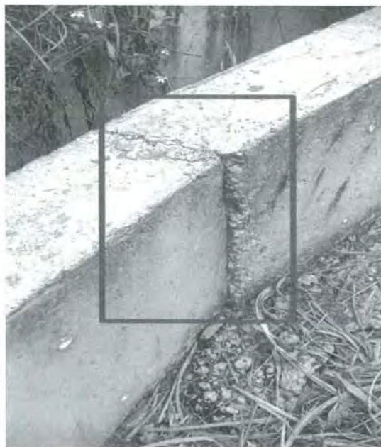
图 30 渠道衔接处错位
