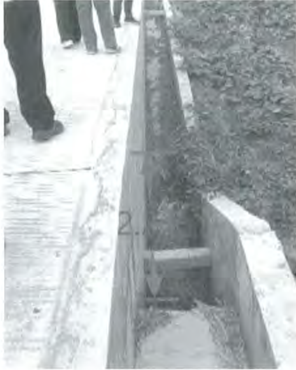
图 21 路面边侧与渠道底部高差达 2.2 米
