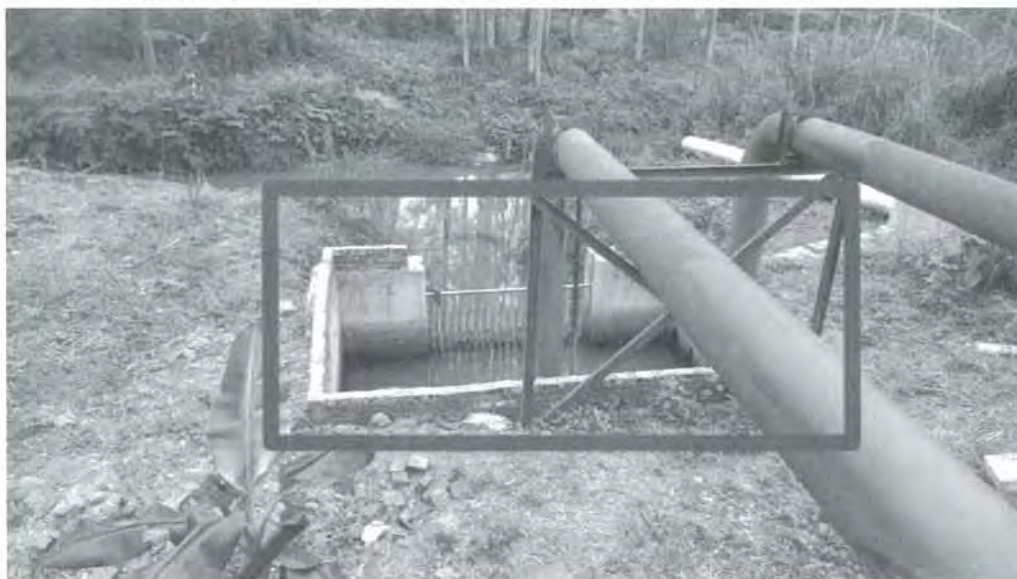
图 31 泵站水池周边未设防护措施
