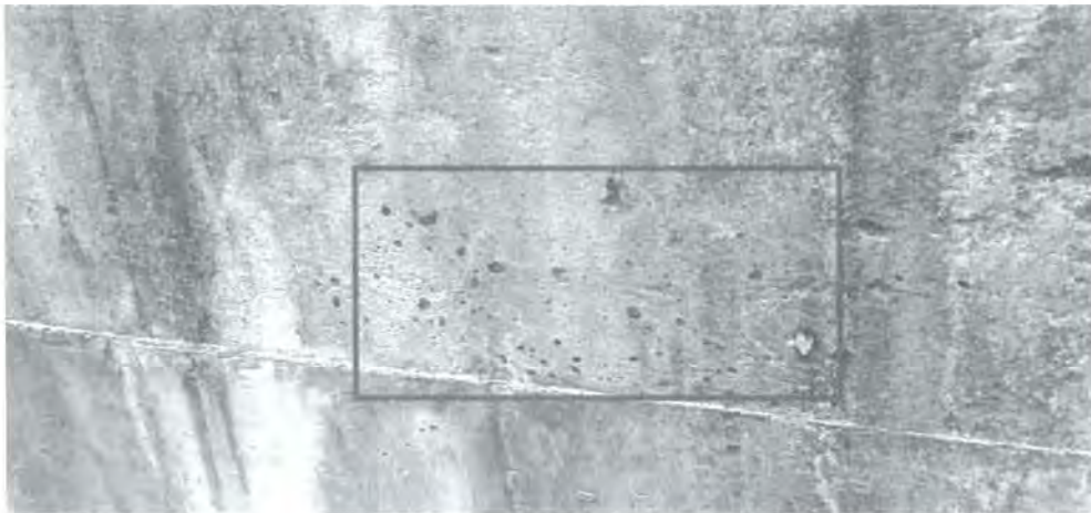
图 6 桥梁梁板侧面蜂窝麻面
