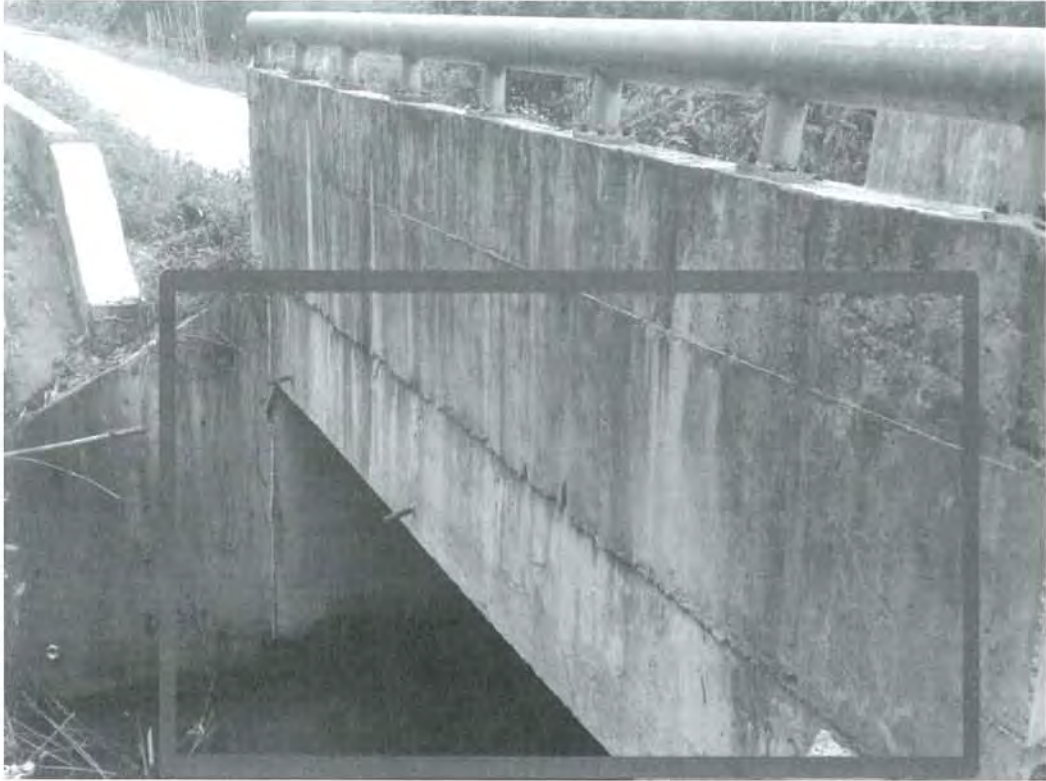
图 7 桥面防撞墙与桥面错位
