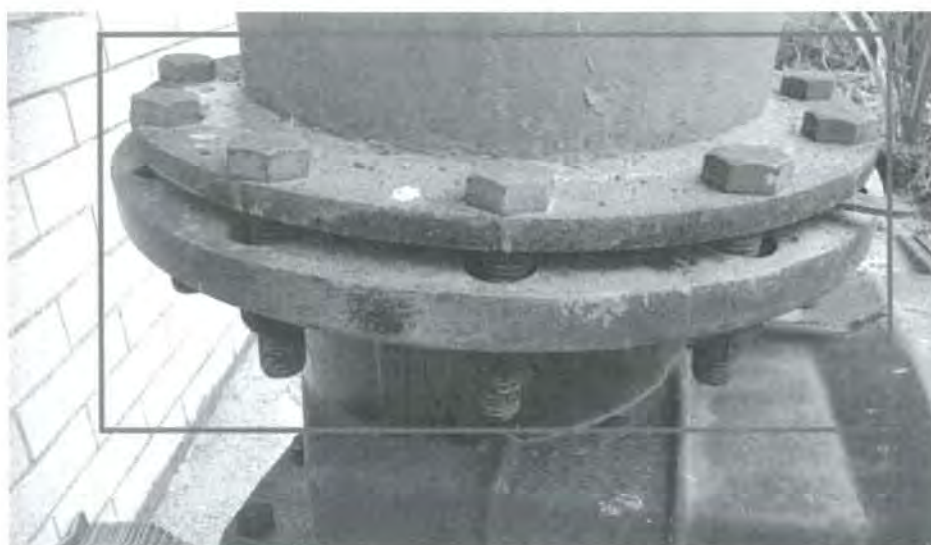
图 32 进水管管道法兰盘螺栓、螺母锈蚀严重 1
