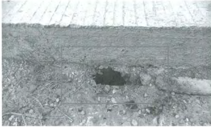
图 27 路面板下边空洞
