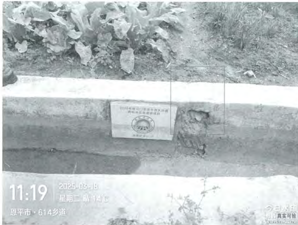
图 3 农渠贯穿性裂缝
