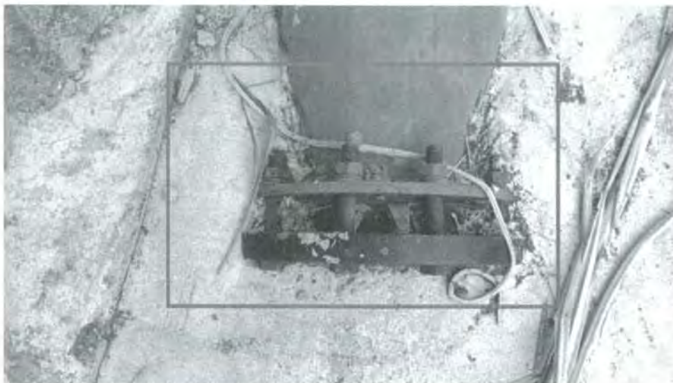
图 33 进水管道法兰盘螺栓、螺母锈蚀严重 2
