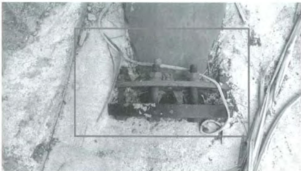
图 33 进水管道法兰盘螺栓、螺母锈蚀严重 2
