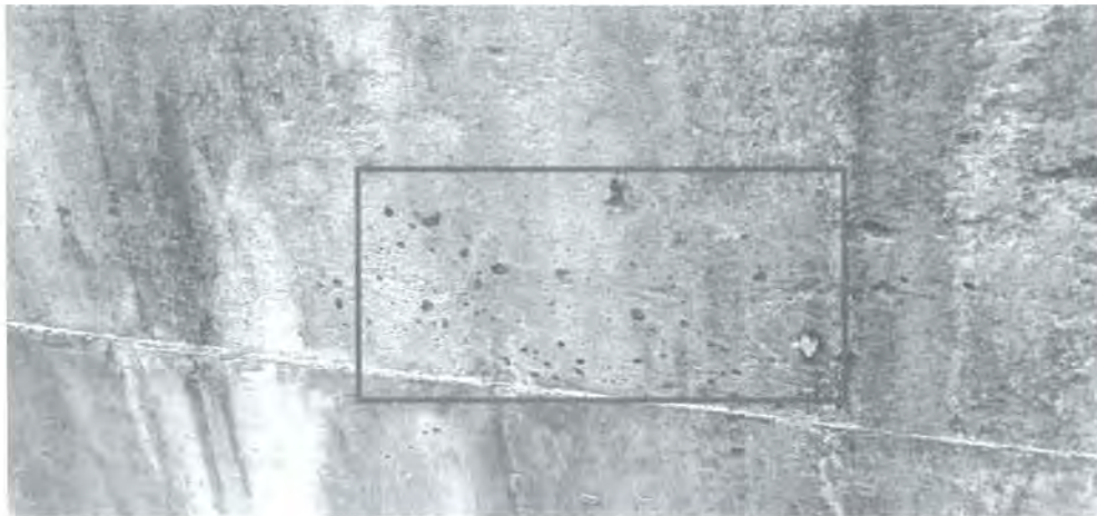
图 6 桥梁梁板侧面蜂窝麻面
