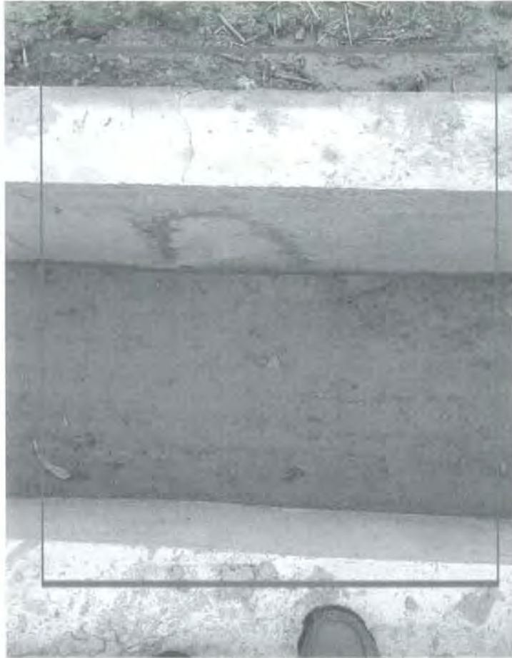
图 24 渠道裂缝及淤积
