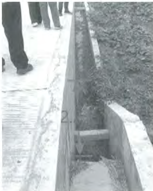
图 21 路面边侧与渠道底部高差达 2.2 米
