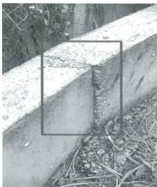
图 30 渠道衔接处错位
