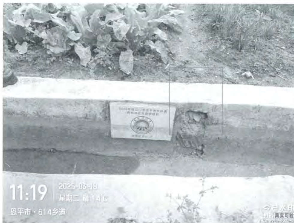
图 3 农渠贯穿性裂缝
