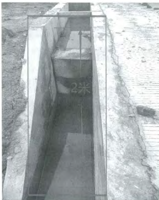
图 23 路面边侧与渠道底部高差约 2 米
